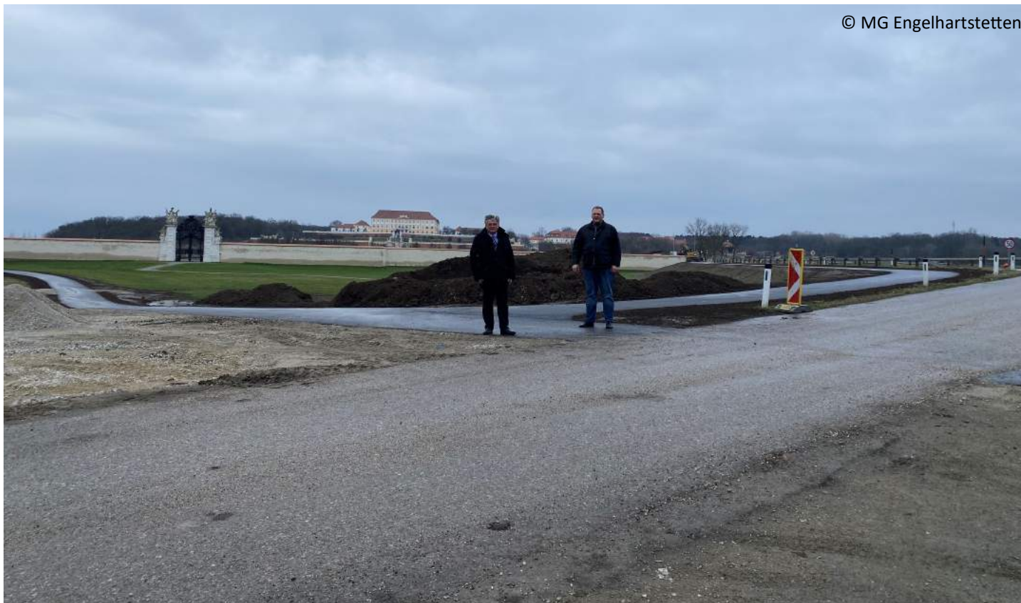
Der neue Radweg rund um Schloßhof nimmt immer mehr Gestalt an - derzeit werden die Nebenanlagen fertiggestellt. Von l.n.r. BGM Josef Reiter, GR Leopold Sabeditsch
